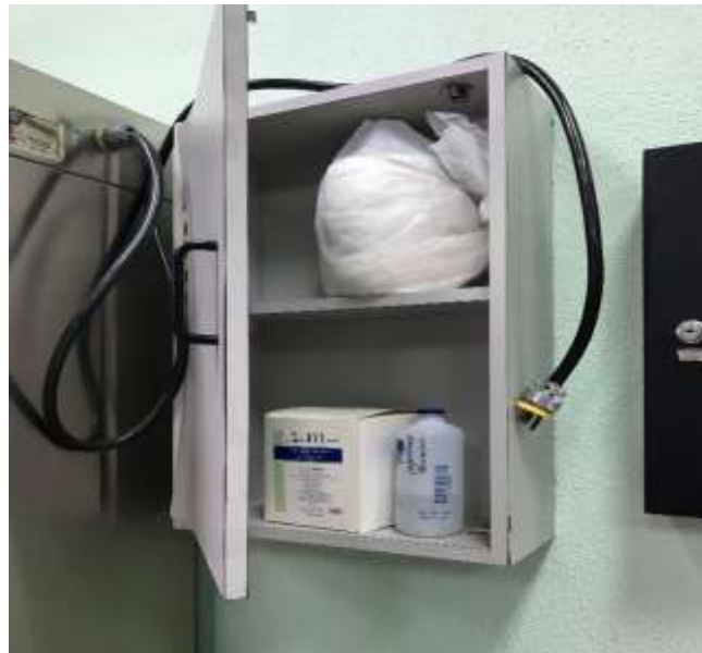
Figura 5. Falta de identificación de botiquín.
