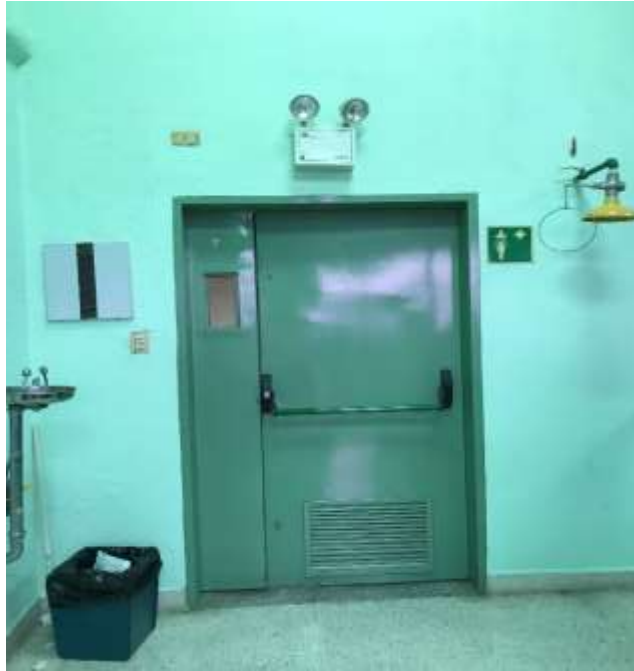
Figura 4. Falta de señalización de evacuación / salida.
