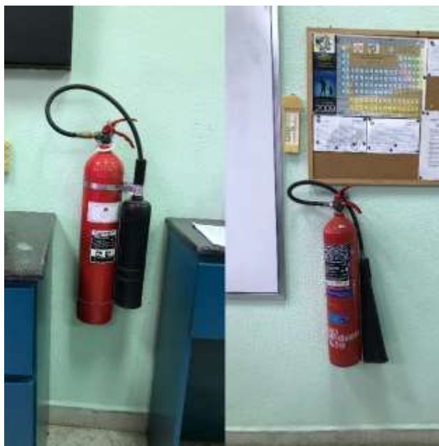
Figura 6. Falta de señalización en extintores. Fuente: Gonzalez M, (2023)
