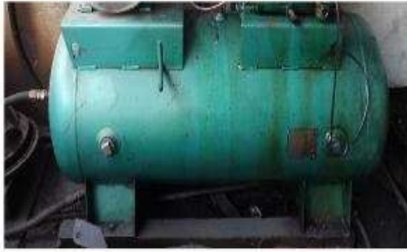
Figura 37 Tanque de almacenamiento Fuente Guevara (2021)
