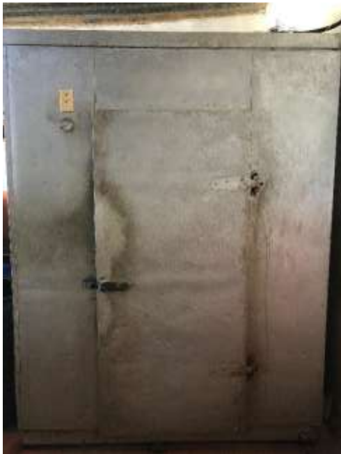
Figura 18 Cuarto de enfriamiento
