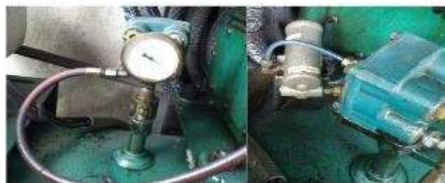
Figura 34 Manómetro y presostato Fuente Guevara (2021)
