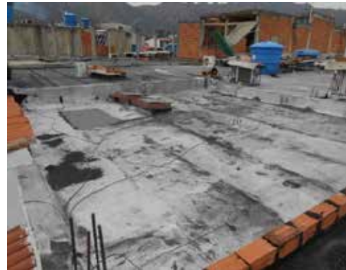
Figura 27. Cableado dist. Interna sin Protección
