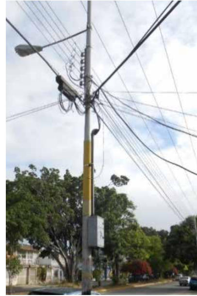
Figura 22. Vista de Muestra poste de derivación Principal Fuente: Bueno, Polanco (2020)
