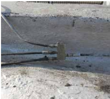
Figura 26. Splitter sin protección contra humedad
