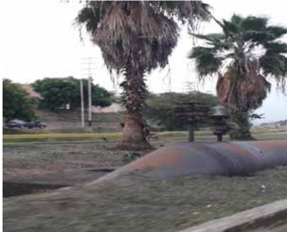
Figura 85. Foto de la tubería de aguas blancas en la isla, a la altura de Pozo Esmeralda, San Diego, Carabobo.
