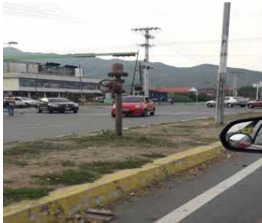
Figura 84. Foto de la tubería de aguas blancas en la isla, a la altura de la embotelladora, San Diego, Carabobo.
