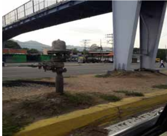
Figura 87. Foto de la tubería de aguas blancas en la isla, a la altura de los Magallanes, San Diego, Carabobo.
