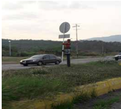
Figura 86. Foto de la tubería de aguas blancas en la isla, a la altura de Farmatodo de Montemayor, San Diego, Carabobo.
